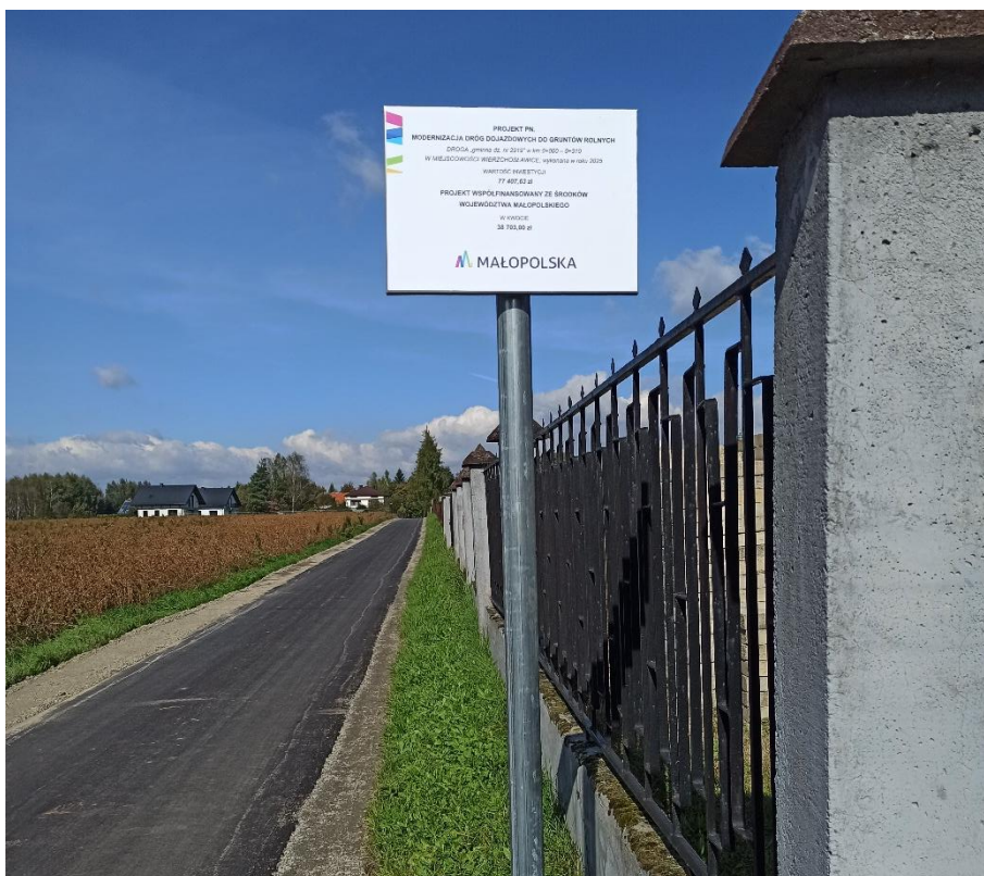
„Remont i modernizacja – droga gminna w km 0+000 – 0+310 działka nr 2919 w miejscowości Wierzchosławice”
